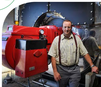
Chaudière générale © F. CHOTARD
